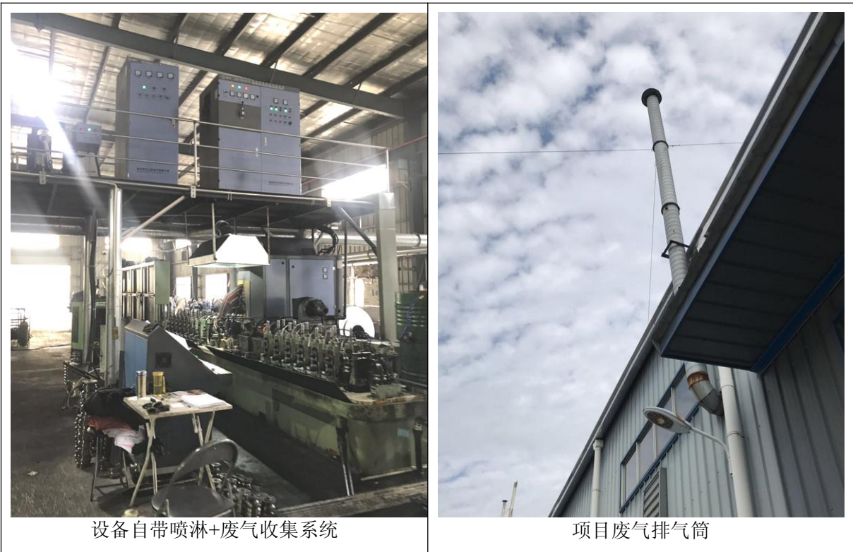
图 3-1 废气处理设施图片
